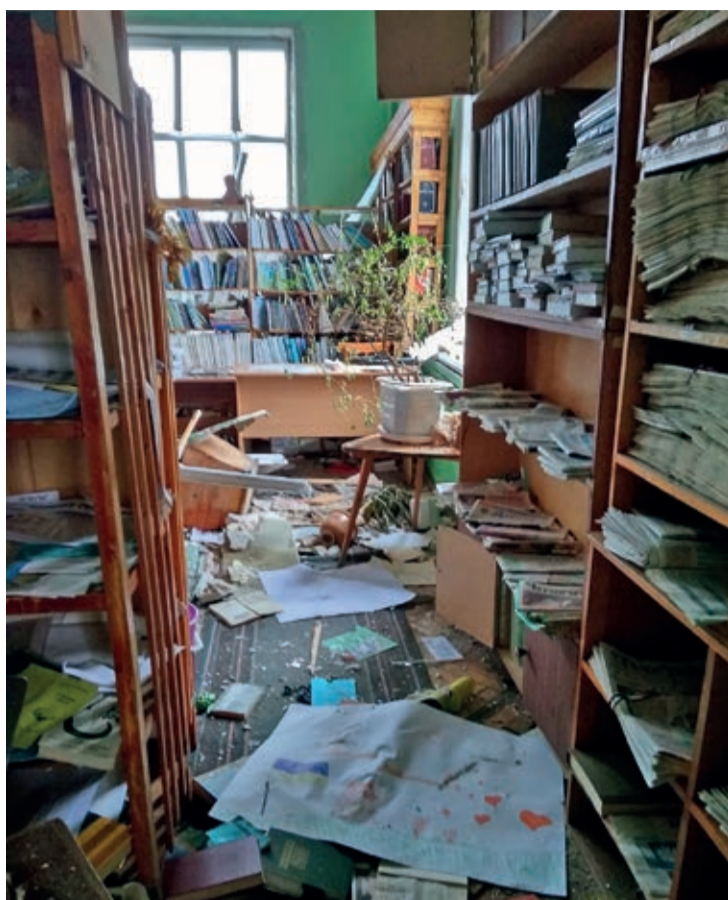
BIBLIOTEKA ZNISZCZONA PRZEZ OSTRZAŁ
